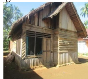
Gambar 1. Rumah Tidak Layak di Kenagarian Koto VIII Pelangai
